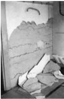
昭和 39 年 地震で崩れた壁面
